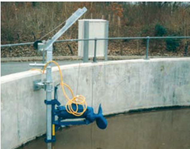
Ponorné miešadlo GTWSI 1040 v nádobe na skladovanie kalu v čističke odpadových vôd
